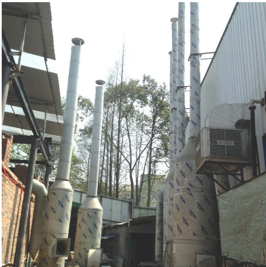
图 2-8:酸雾净化设施
